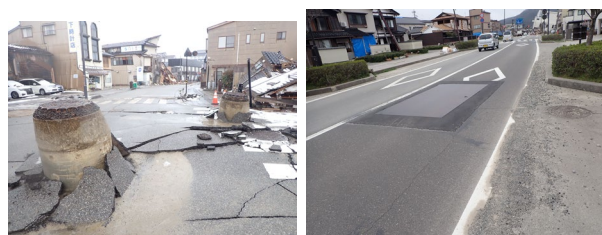
図 9 輪島市内の液状化で浮き上がったマンホールとその補修後 (左: 1 月撮影, 右: 3 月撮影)
