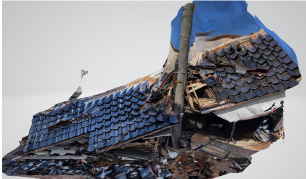
b) 倒壊して電柱に倒れ掛かった木造建物
