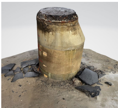
a) 液状化で浮きあがったマンホール
