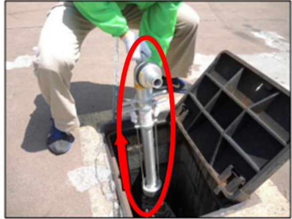
写真 スタンドパイプ
