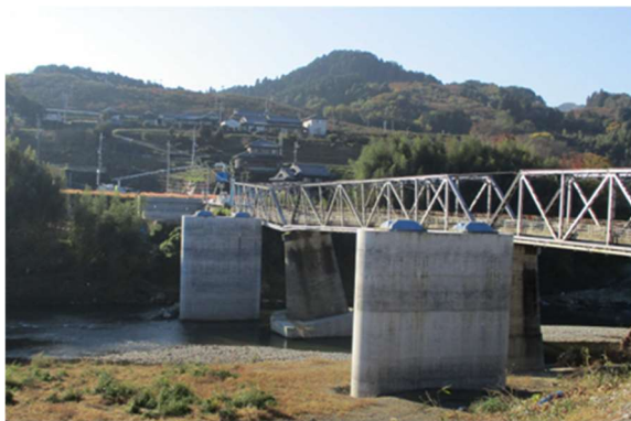
写真1 橋脚の変位による路面の屈曲
